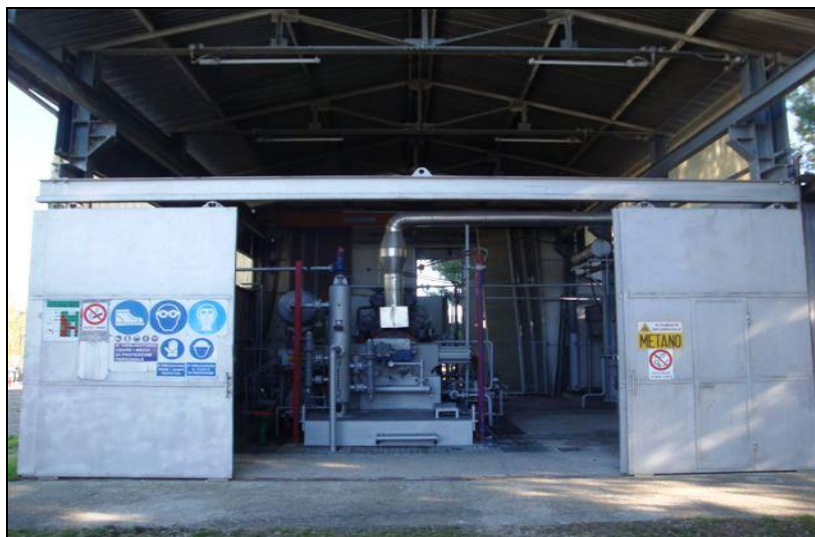
Ingresso locale compressore presso la C.le di Garaguso
