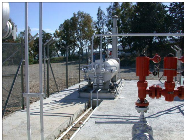
Piazzale pozzo AC4
