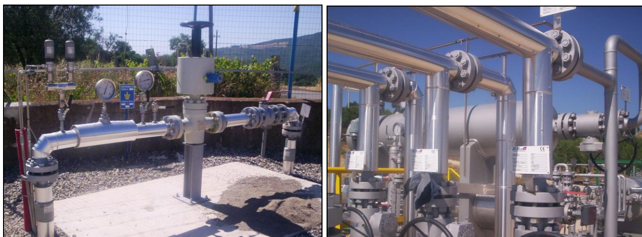
Figura 2 - Parti di impianto presso l'area pozzo AC2
